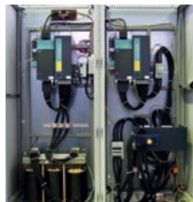
Hardware in the Loop Prüfstand für die Leistungselektronik
